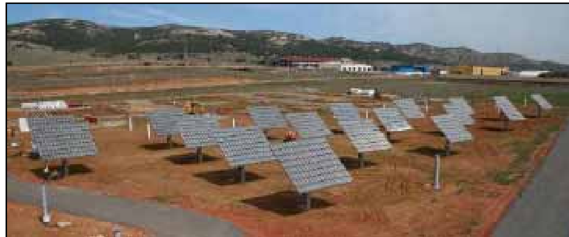
Planta fotovoltaica com SFVC
