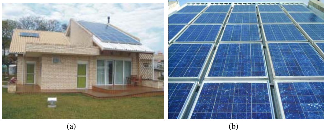
Figura 2. Fachada norte da Casa Eficiente, com coletores solares para aquecimento de água e módulos fotovoltaicos para geração de energia elétrica e detalhe dos módulos de silício cristalino.
